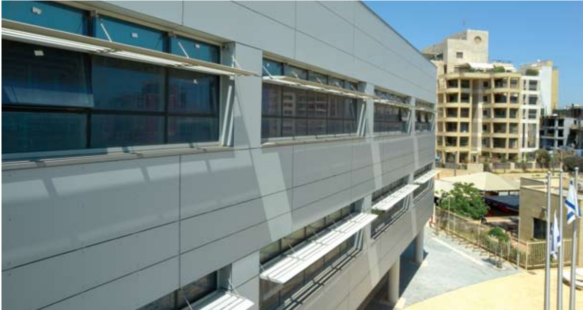
אלמנט הצללה בחלונות ביה"ס "נופי ים" | תל אביב. אדריכלית: פרלה קאופמן ועיריית תל אביב מחלקת מבני ציבור ומשרד אדריכל העיר (באדיבות יפתח הררי אדריכלים יועצי בניה ירוקה והחברה למשק וכלכלה)
